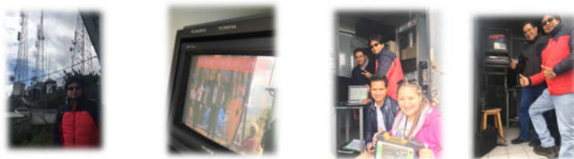
Figura 6. Instalación, interconexión y configuración del servidor EWBS y multiplexor en el cerro Pichincha
