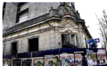
ESQUINA DEL "VIEJO CORREO". ACTUALMENTE HOTEL EN CONSTRUCCIÓN. SE RESPETA FACHADA FRANCESA. FOTO PABLO VILLANUEVA
