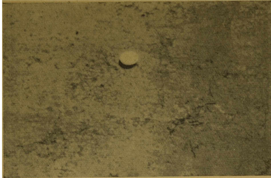
FIG. 110. — Detalle de la calzada terminada; pueden apreciarse pequeñas fisuras superficiales
