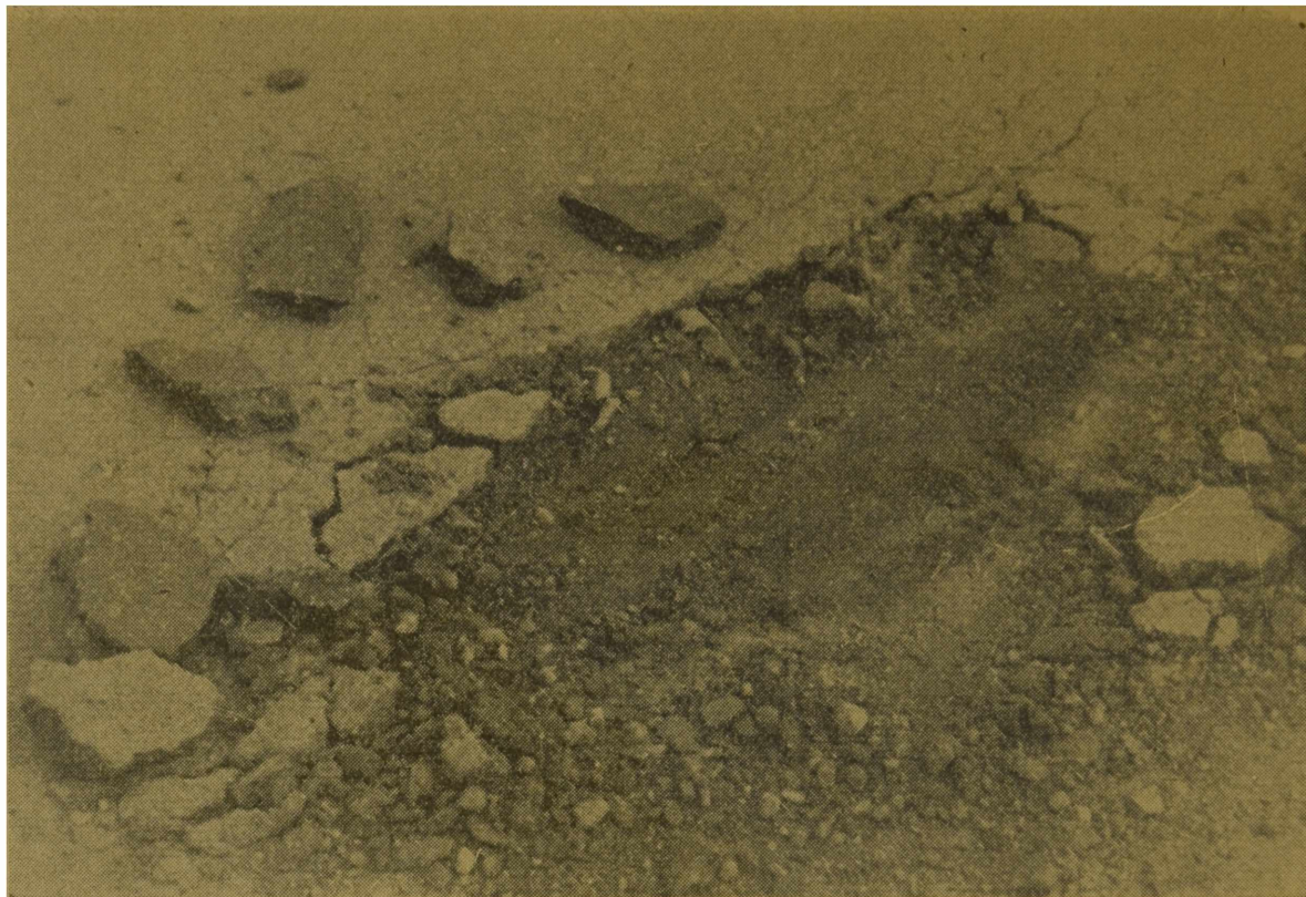
FIG. 4. — Fallas en una base del tipo fino ocasionadas por la compactación en capas delgadas. Estas fallas han sido eliminadas utilizando los procedimientos constructivos recomendados.
