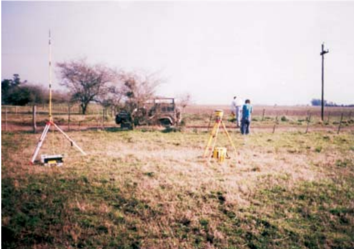
Receptor base estacionado para realizar mediciones de servidumbre de oleoducto. Se trabajó con distancias de hasta 11 km. sin ningún problema en el enlace de radio gracias a la topografía que se puede apreciar.
