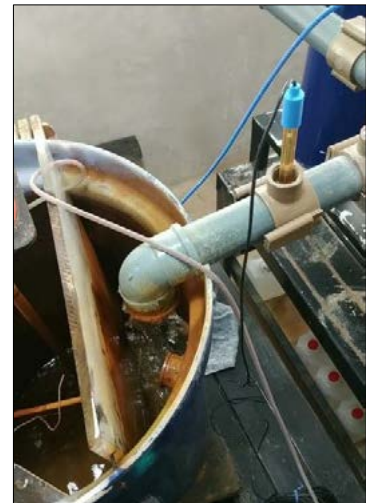
Figura 6: Punto de instalación de la sonda de pH en planta.
