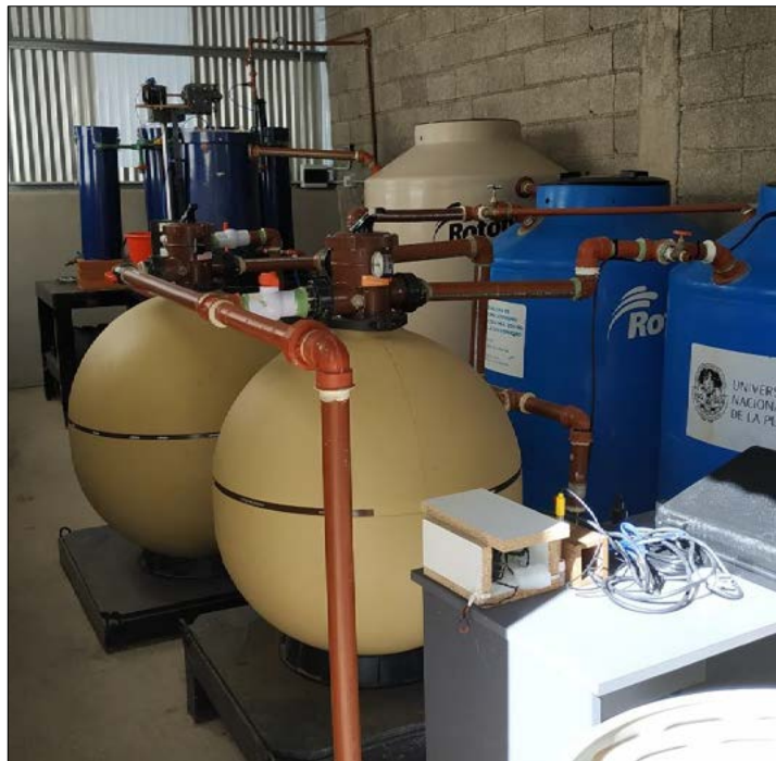
Figura 1: Planta potabilizadora, localizada en Pipinas.
