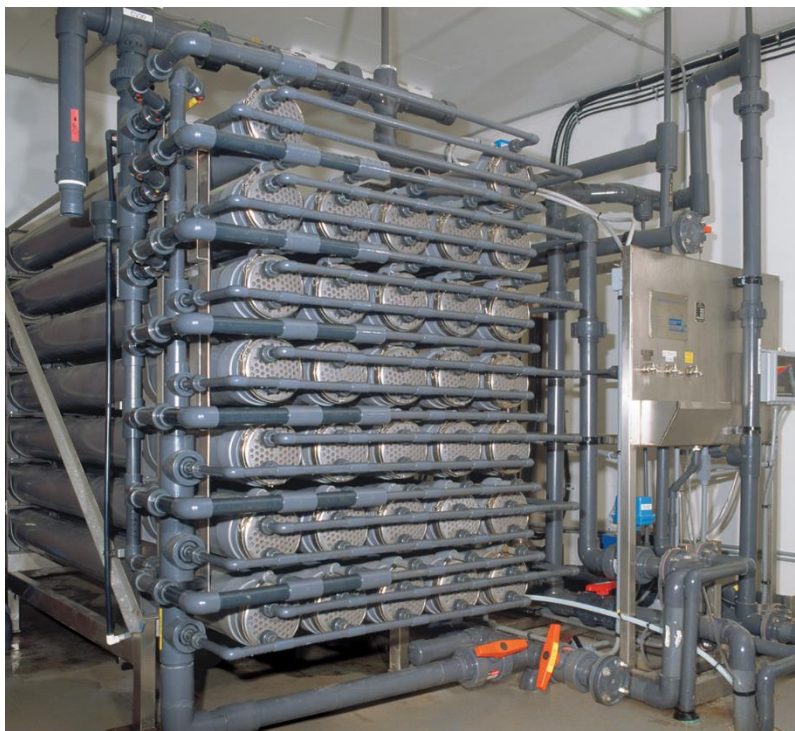
Equipo de tratamiento de membrana
