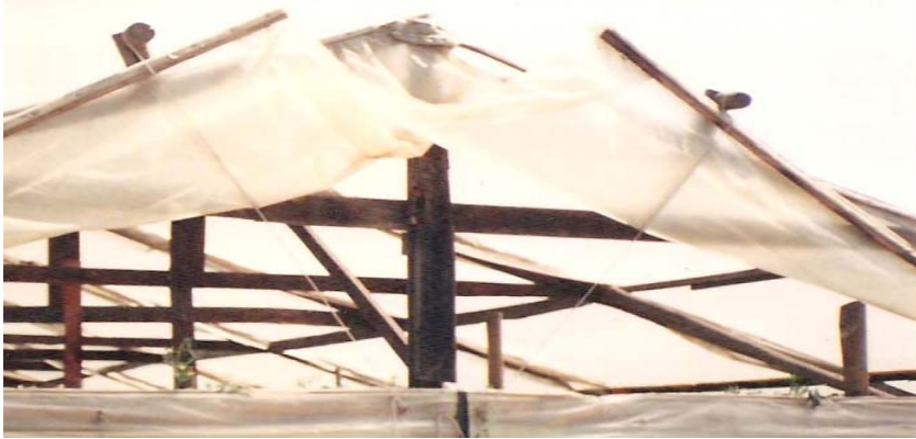
Foto 8: Diferentes formas de ventilación en invernaderos
