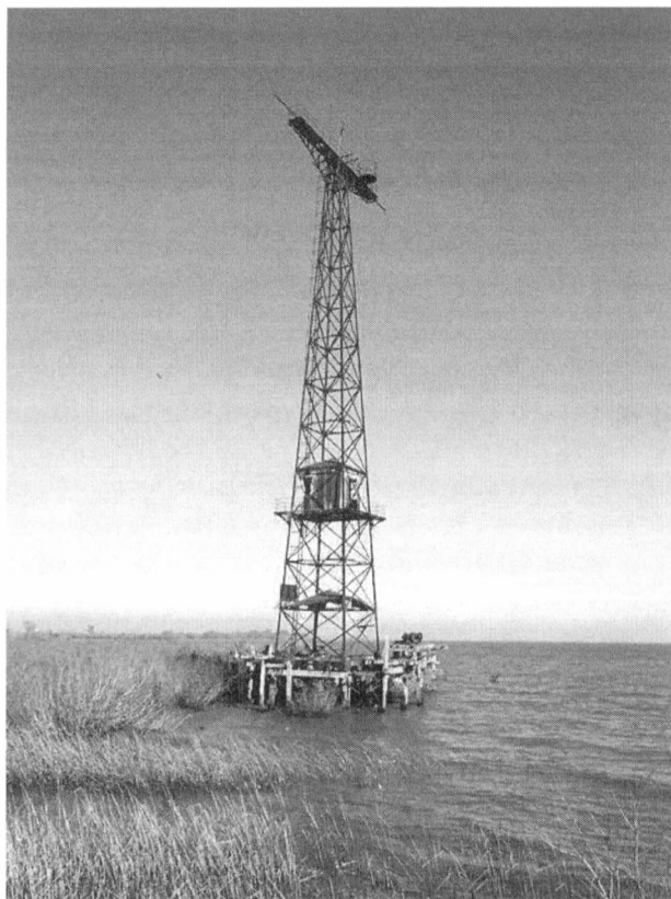
En la entrada del puerto La Plata, sobre la Isla Paulino, se yergue moribunda, la estructura del semáforo fluvial que alertaba, años atrás, sobre el nivel de las mareas del Río de La Plata y la dirección de entrada al canal, a los barcos que navegaban con destino a YPF y a los frigoríficos. Fotografía: Julio A. Milat. 3 oct 2015
