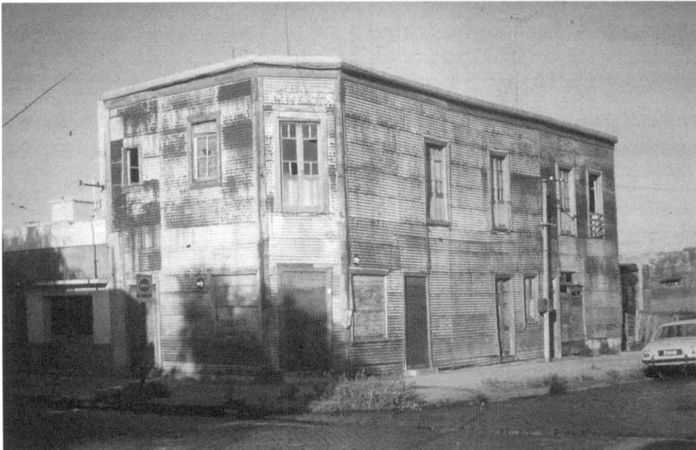
Otro ejemplo de casa típica del citado barrio en una esquina de la calle Valparaíso, que el tiempo carcomió con su óxido y debilitó en su esqueleto de madera, para llevársela al olvido y la última memoria de los ancianos. Fotografía: Juan F. Klimaitis. 14 feb 1980
